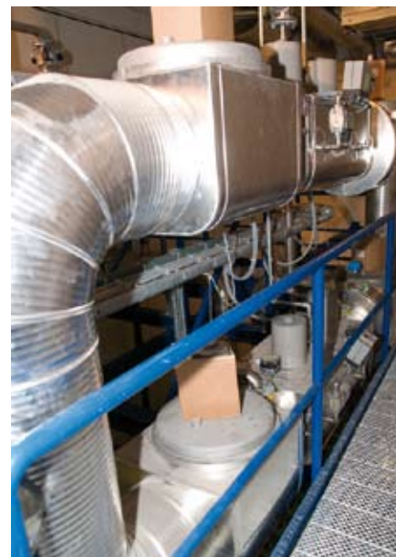
Gasrampe til den nye gasturbine.
